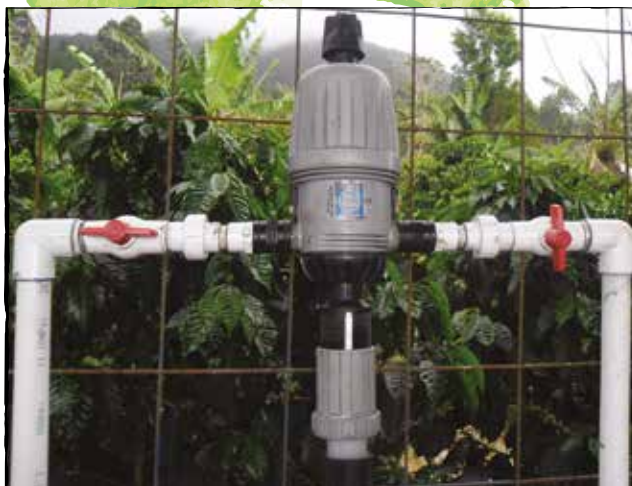
Figura 17. Bomba pequeña que impulsa el riego.
